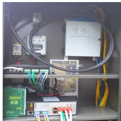
함체 내부에 설치된 스위치 장비
