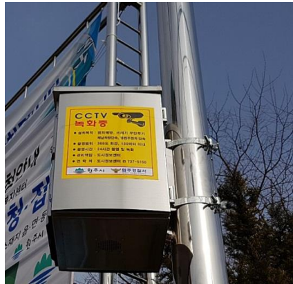
외부에 노출된 CCTV
